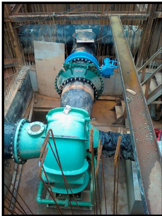
Foto 1- Conjunto Moto bomba (Fonte: autor)
